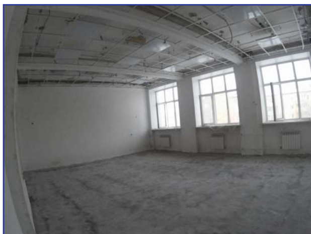
Во всех учебных кабинетах установлены пластиковые окна
